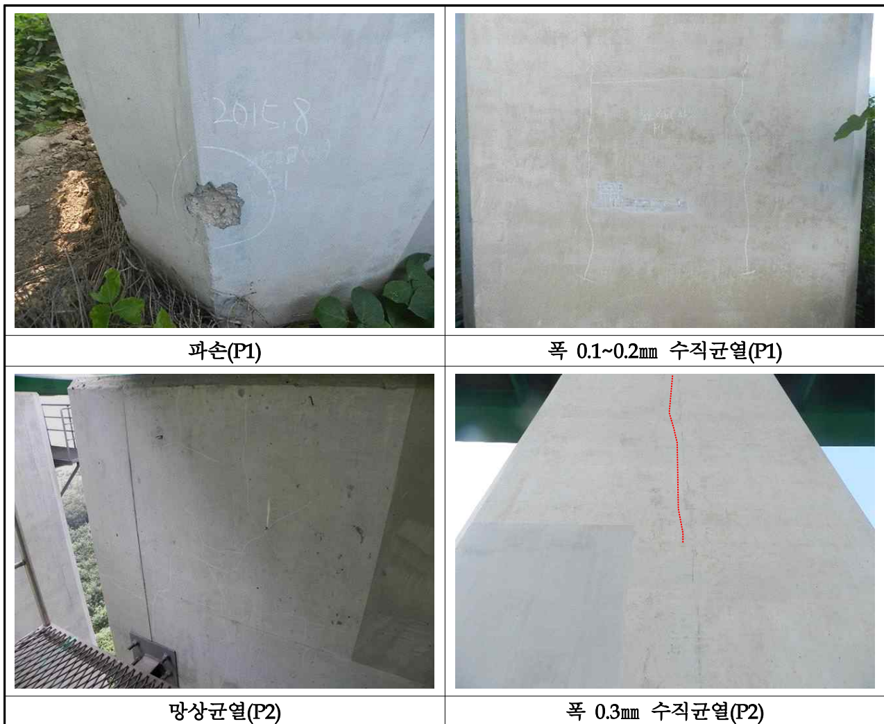
【사진 3.3.9】 교각 손상현황(부산)
