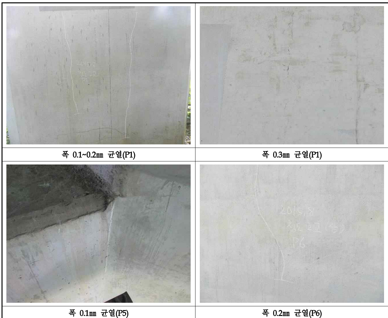
【사진 3.2.10】 교각 손상현황(대구)
