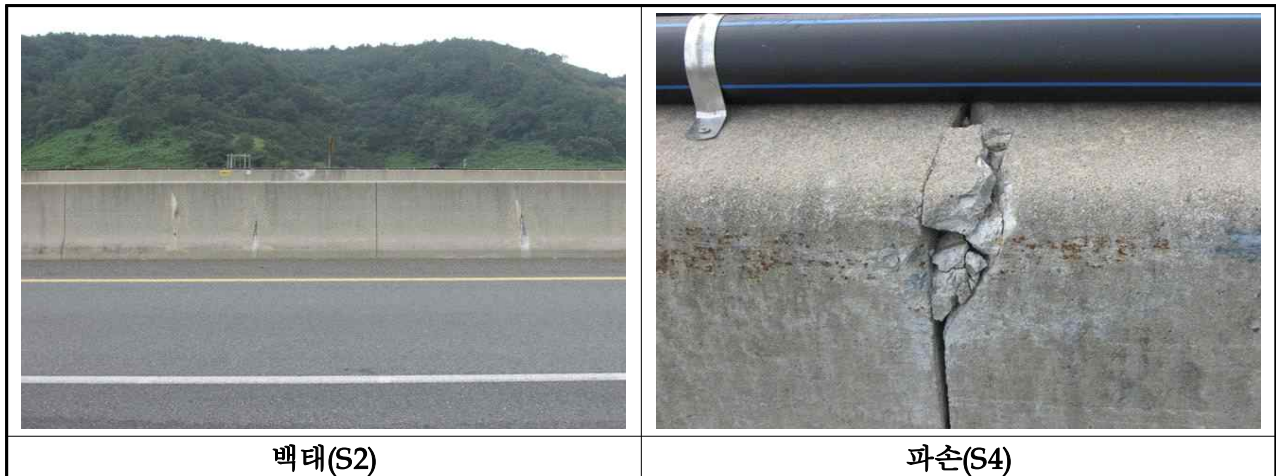
【사진 3.3.22】 난간 및 연석 손상현황(부산)
