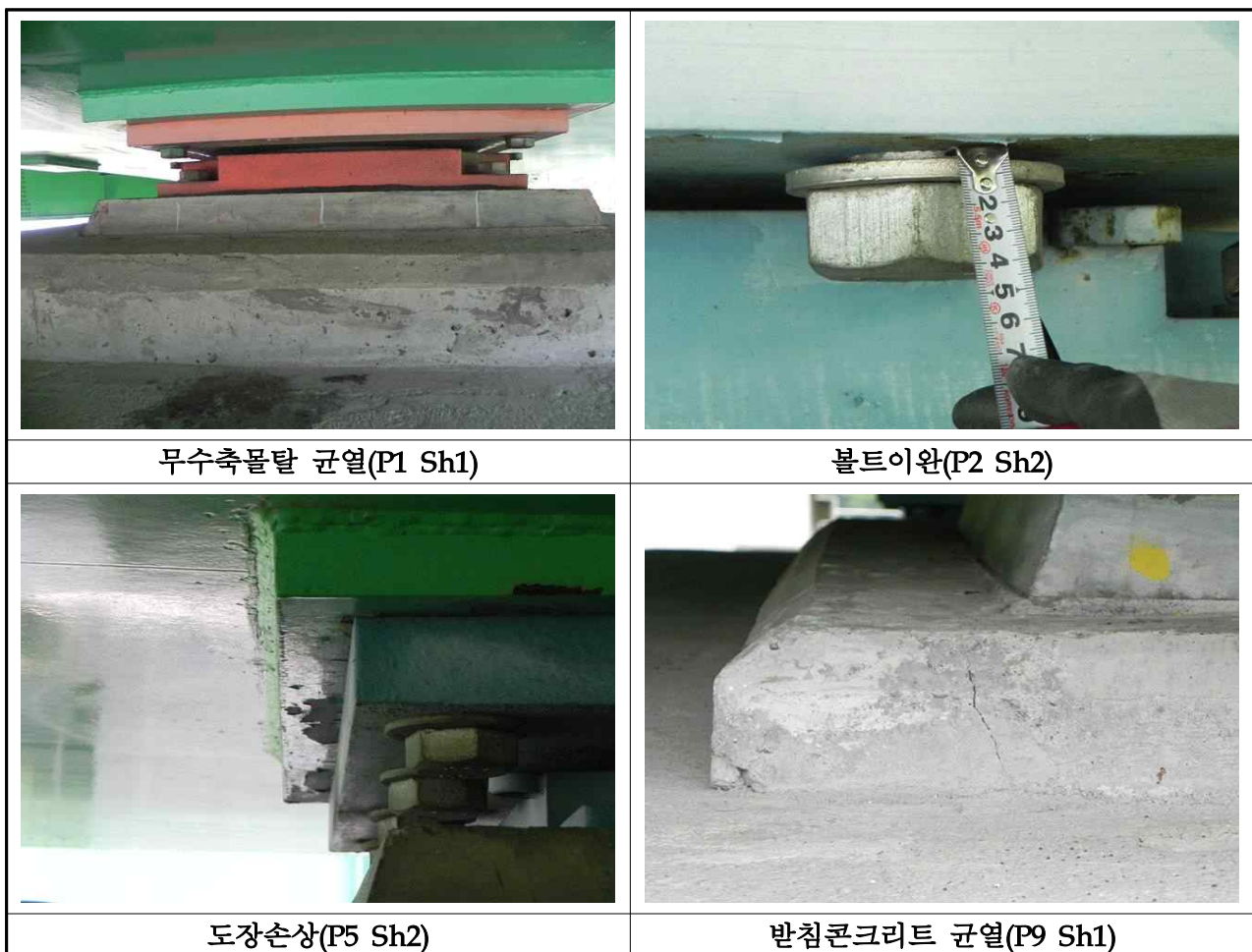
【사진 3.3.12】 교량받침 손상현황(부산)
