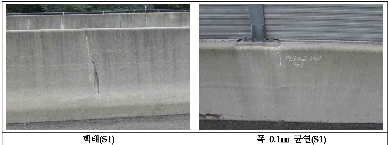
【사진 3.2.22】 난간 및 연석 손상현황(대구)
